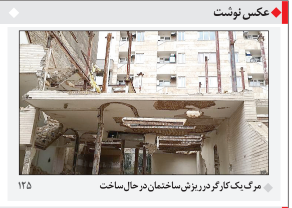
مرگ یک کارگر در ریزش ساختمان در حال ساخت
